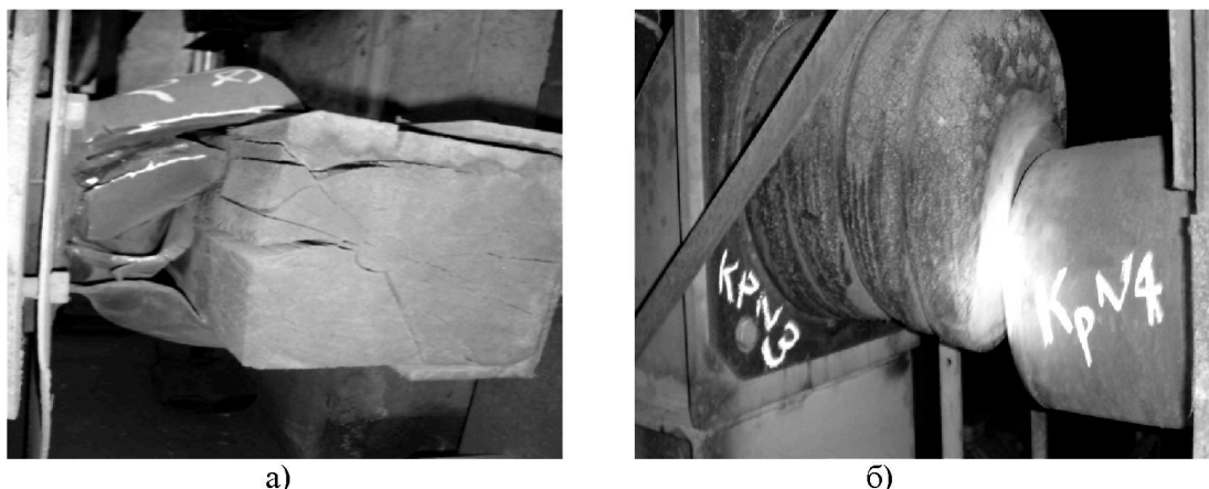
Рис. 1. Повреждаемость буферов мостовых кранов: а – полное разрушение резинового БУФ мостового крана г/п 15 т при наезде на ТУП; б – частичное повреждение полиуретанового БУФ мостового крана г/п 50х2 т при столкновении с БУФ другого крана
